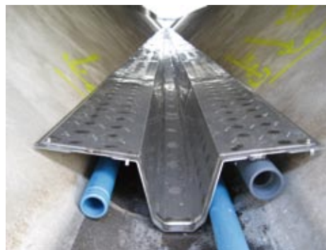
Nachträglich eingebautes System
