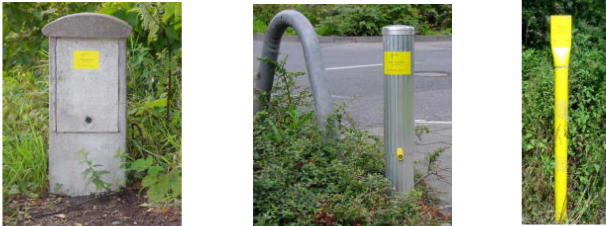
Abbildung 5 Messstellen für kathodischen Korrosionsschutz
